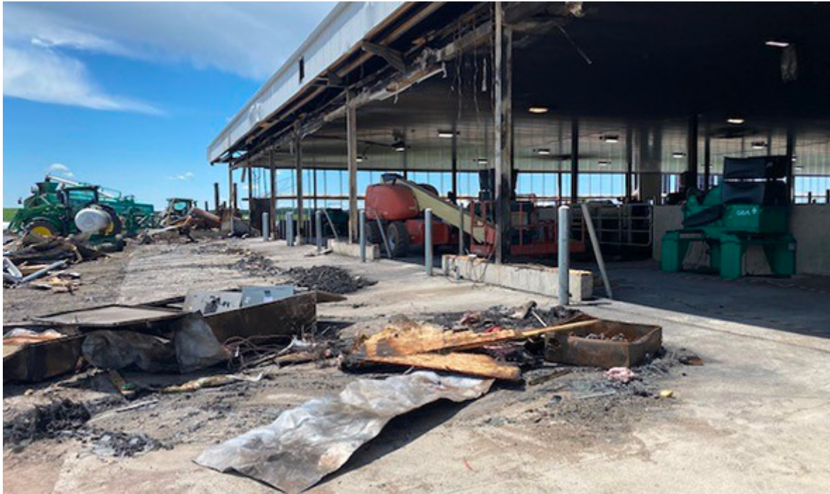
Le bâtiment qui abritait le système d'évacuation du fumier à la Ferme Lansj, dans le Centre-du-Québec, est complètement détruit. Il avait été construit en 2019. Photo : Gracieuseté de Sylvain Landry
