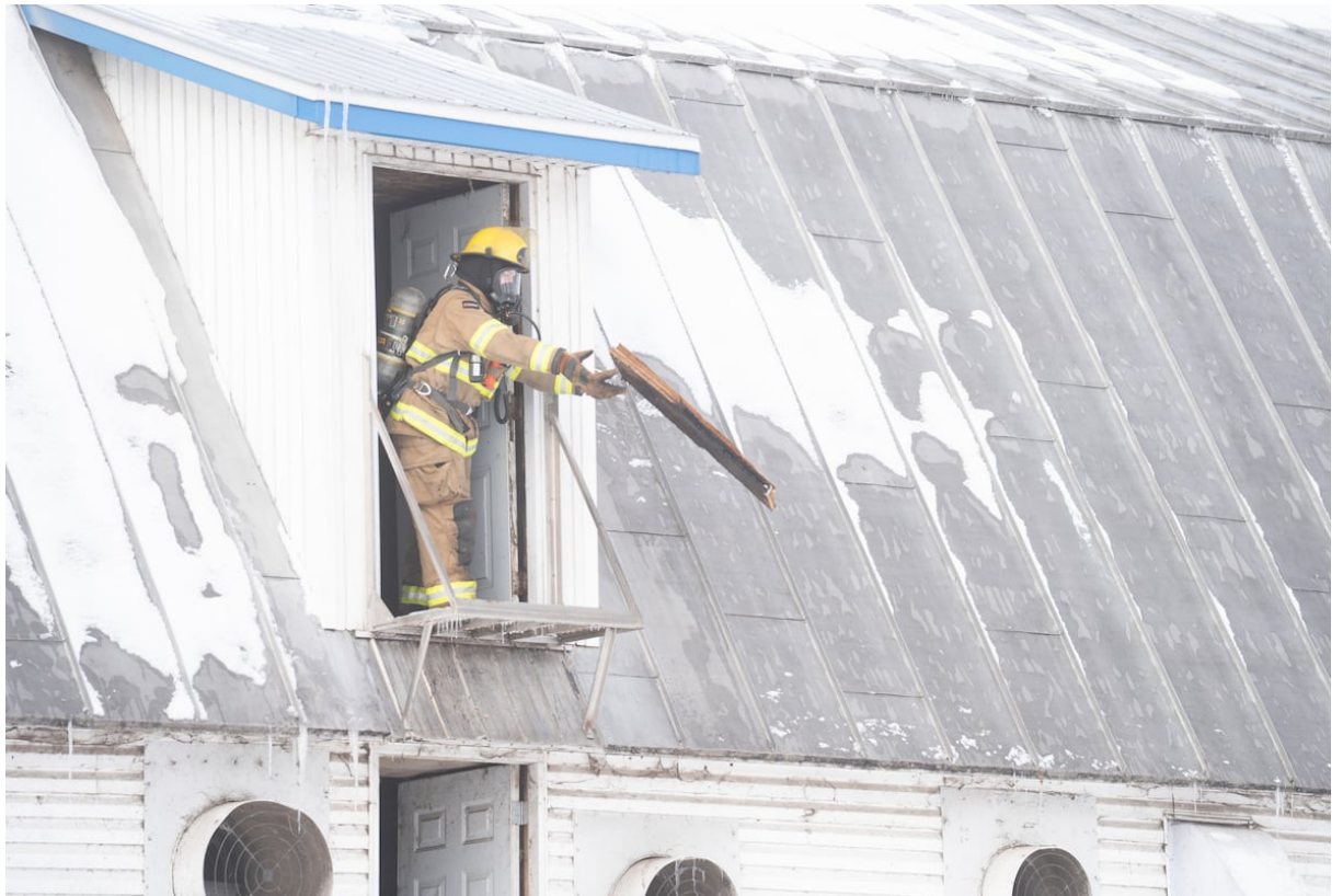
Trois étages du poulailler ont subi des dommages. (Stéphane Lessard/Le Nouvelliste)
